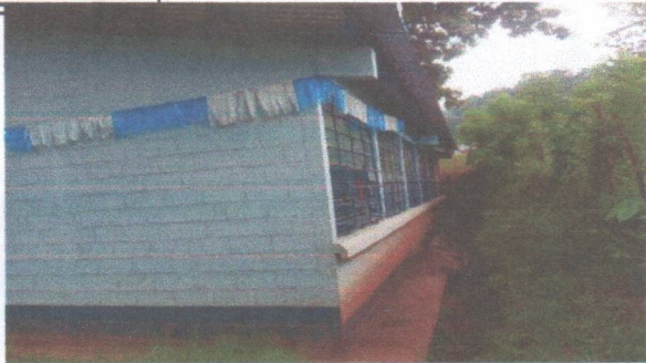
Foto1: Se observa que hace falta pintura en exterior y exterior
